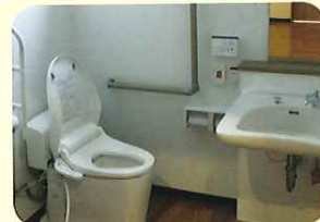
トイレ（バリアフリー） 最新のバリアフリートイレを採用しております。施設内に6ヶ所完備しました。
